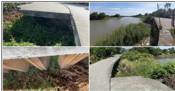
Fig. 1 Actual condition of Arnedo Dike at Purok 8, Sto. Tomas, San Luis
