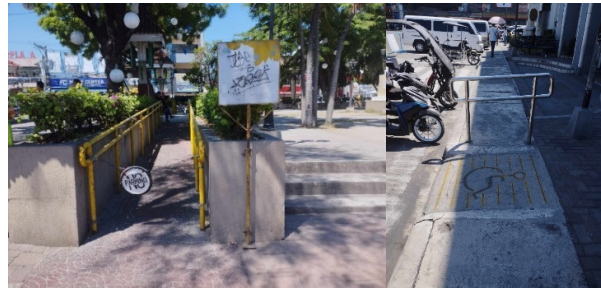
Fig. 12. Signage 3 Fig. 13. Dropped Curb 1
